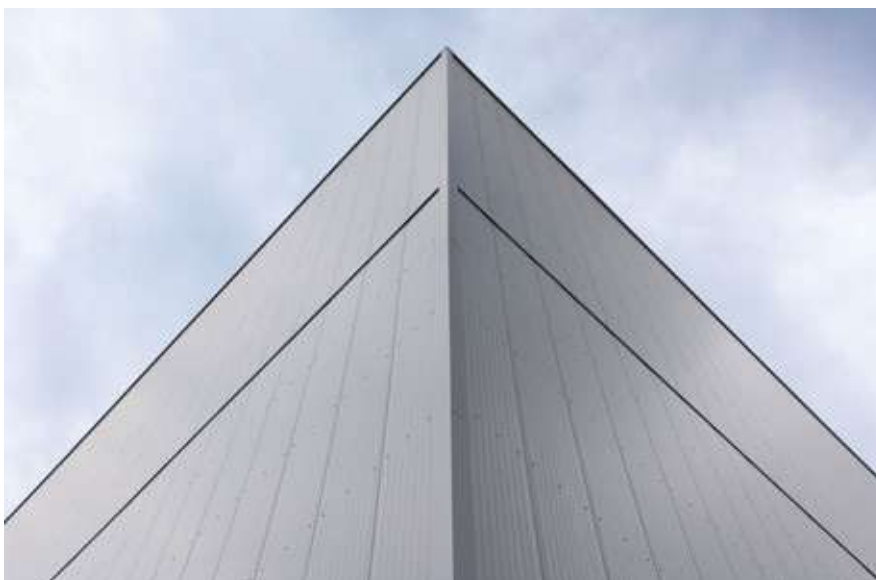
Hochregallager mit vertikaler Verlegung.
